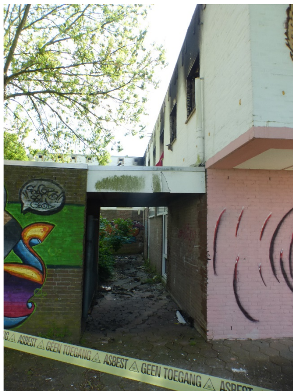
Foto: vrijkomen asbest na brand
